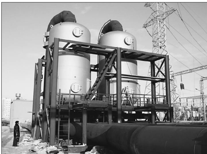
Рис. 7. Грязевики ГИГ – 6000 ВК на Приморской котельной Установлены в 2009 г.
