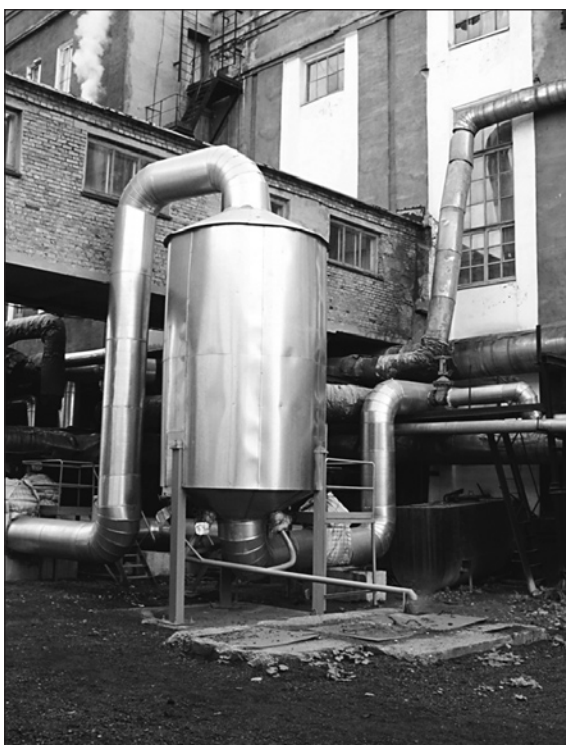
Рис. 6. Интинская ТЭЦ ОАО «ТК-9» Грязевик ГИГ – 2300. Установлен в 2007 г.
