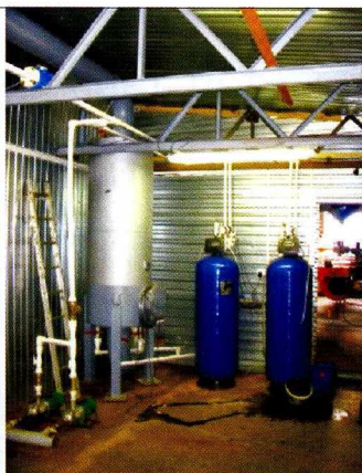
Фото 10. Общий вид грязевика «ГИГ-350» и сорбционных фильтров
