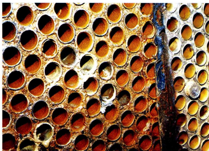
Фото 19. Общий вид трубной доски в поворотной камере теплообменника
