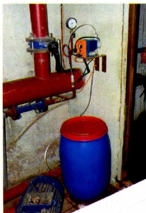
Фото 8. Общий вид установки дозирования коррекционного состава.
