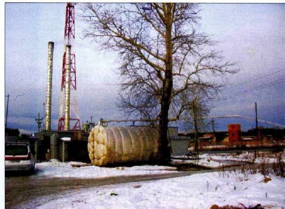
Фото 9. Котельная в пос. Лосиный. На первом плане - азрационная ёмкость станции обезжелезивания
