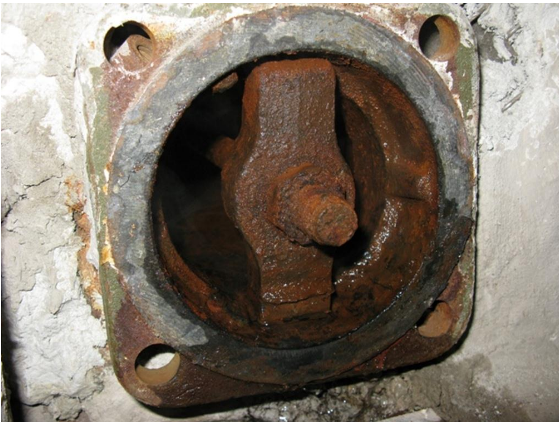
Коллектор водогрейного котла. Март 2010 г
